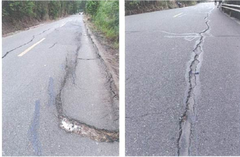
图 2-1 维修保养路段路面破损现状
