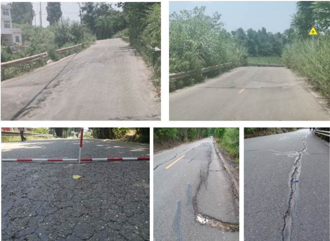
图 3-2 路基沉陷、路面损坏
