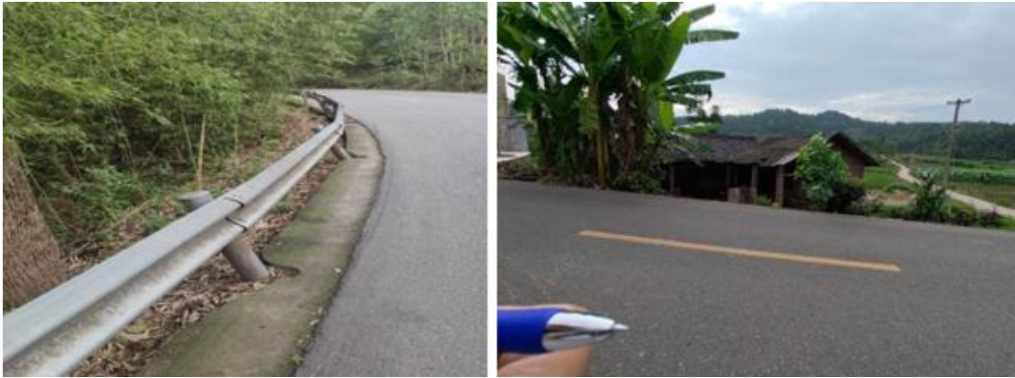
图 3-3 沿线设施损坏或缺乏
