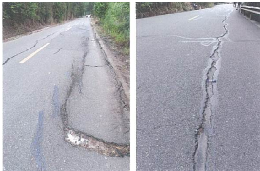
图 2-18 维修保养路段路面破损现状
