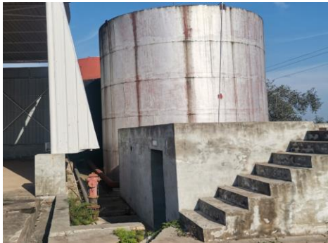
水泵房及消防水储罐
