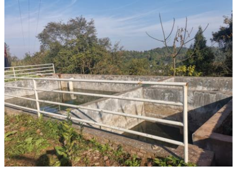
初期雨水收集池及隔油沉淀池
